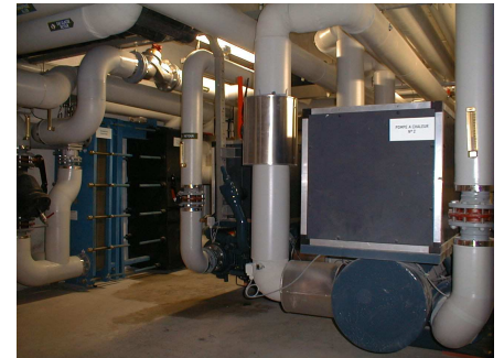
La régulation thermique des aquariums est assurée par des pompes à chaleur
