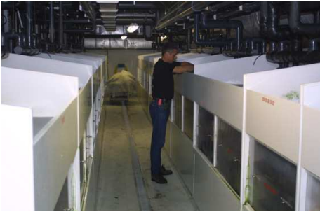
L'une des salles de filtration
