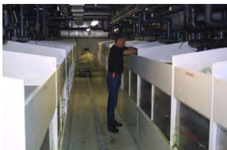
L'une des salles de filtration
