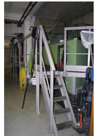
Des galeries techniques permettent d'accéder aux aquariums afin d'en assurer la maintenance
