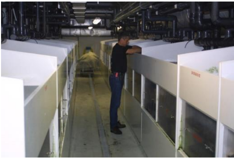
L'une des salles de filtration
