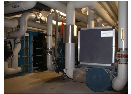
La régulation thermique des aquariums est assurée par des pompes à chaleur
